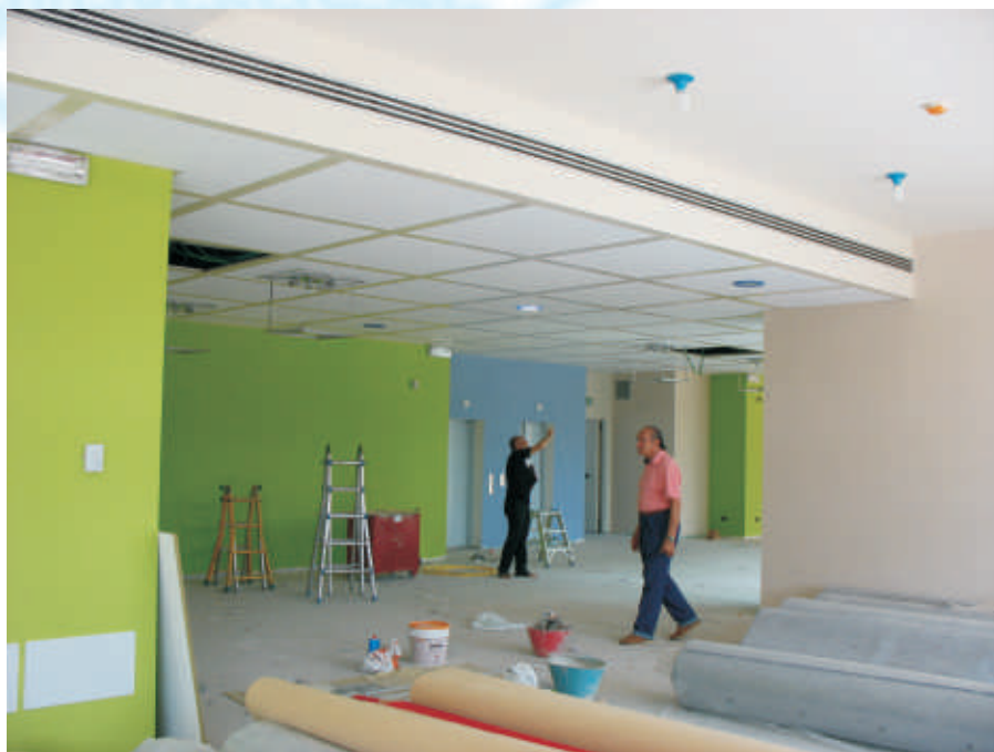
Una recente immagine dell'Albergo foresteria ANUSCA. Il Direttore Zarotti ispeziona l'andamento dei lavori.
